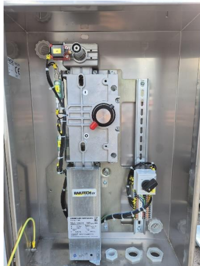
Figuur 13 Uitgeschakelde motorkast
