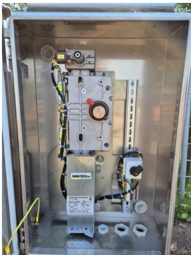
Figuur 12 Ingeschakelde motorkast
